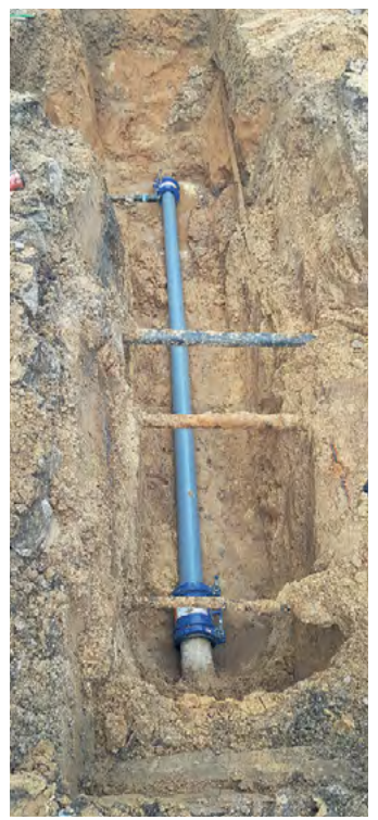
Der Blick in die Grube zeigt eine der drei Stellen, an denen das Rohr gebrochen war. Die blaue Leitung ist das neue Rohrstück.
