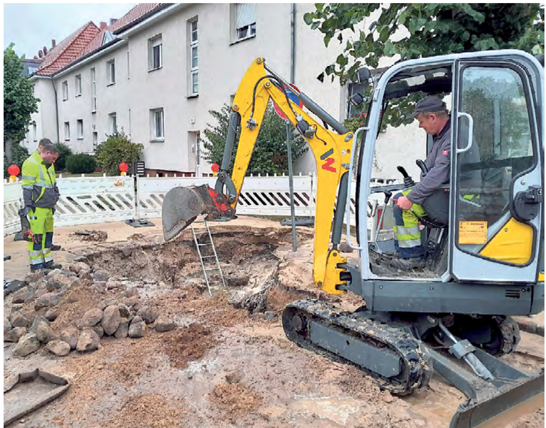
Die Wassermassen haben in der Straße ein großes Loch hinterlassen. Dem rückte der Verband zusammen mit seinem eigenem Tiefbau-Equipment schnell zu Leibe.
